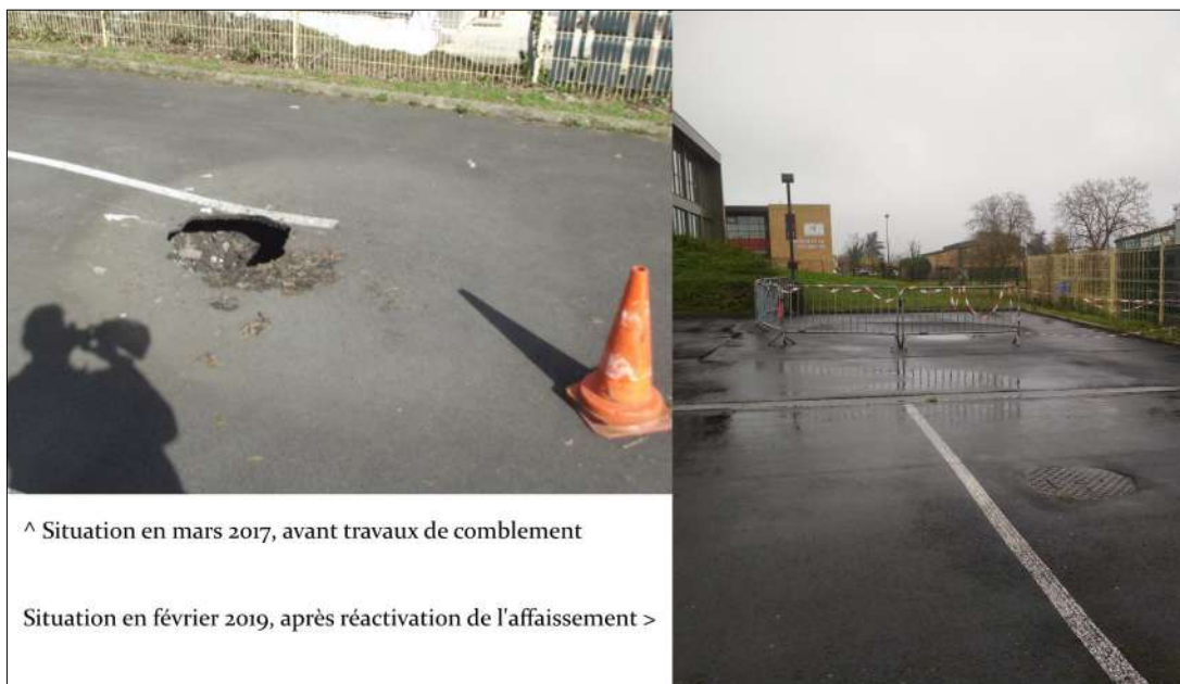
Figure III.23: Affaissement au niveau du parking de l'IRSTS. Source: mairie d'Arras et AGR.
