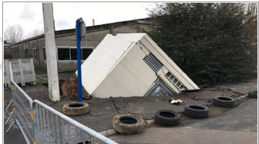
Figure III.6: Engloutissement d'un transformateur EDF à Beaurains (février 2018)
