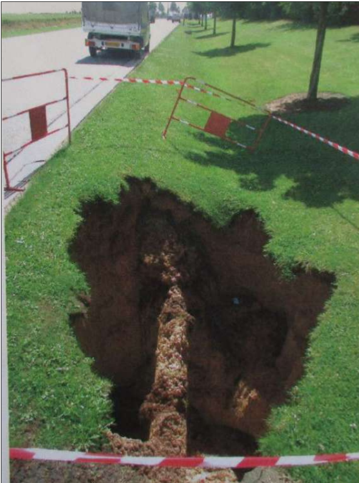
Figure III.18: Fontis le long de la chaussée du barreau sud. Source: Mairie d'Arras (ARR296)
