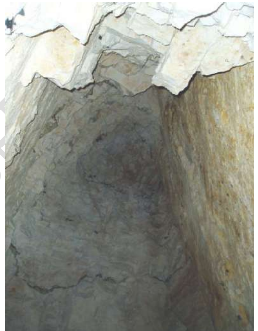
Figure III.1: Montée de voûte entre 2 diaclases qui ont « prédécoupé » la masse crayeuse (Etrun (62), CEREMA)
