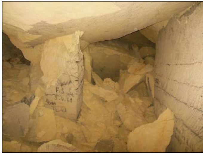
Figure III.8: Éclatement d'un pilier et affaissement du toit (Saint-Même-les-Carières)
