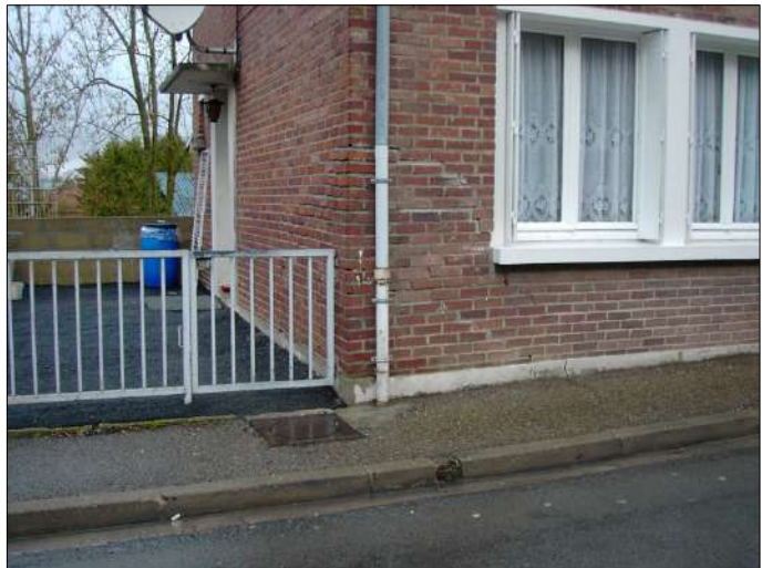
Figure III.4: Tassement sur terrains sous-cavés à Montdidier
