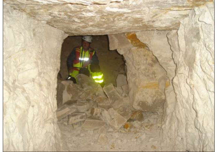
Figure III.5: Effondrement du toit (rue des Hochettes - Arras)
